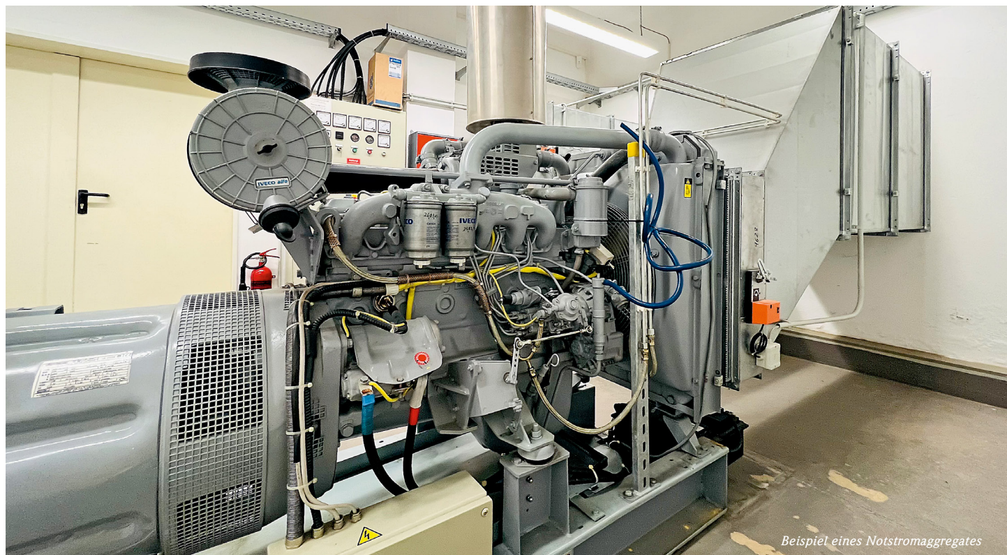
Beispiel eines Notstromaggregates
